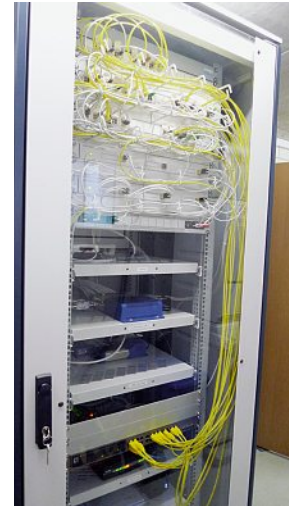
Die BKS-Verteilzentrale für das vernetzte Haus.
